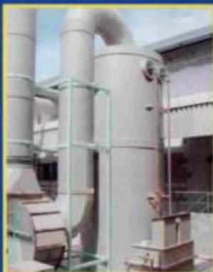
Lavadores de gases
