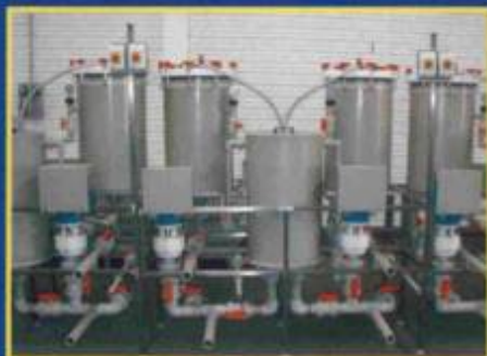
Conjunto de filtração
